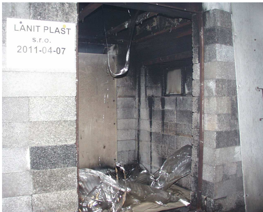
Pohled na zkušební vzorek č. 1 po zkoušce
